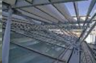
L'éclairage naturel des salles d'exposition est contrôlé par des brise-soleil inclinables sur le toit.
